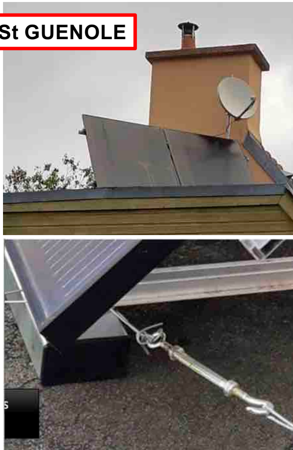
Poutrelle, lest et tendeurs, attention à l'ombre de la parabole
